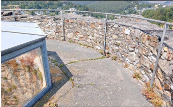
Aussichtsplattform mit alten Belag
